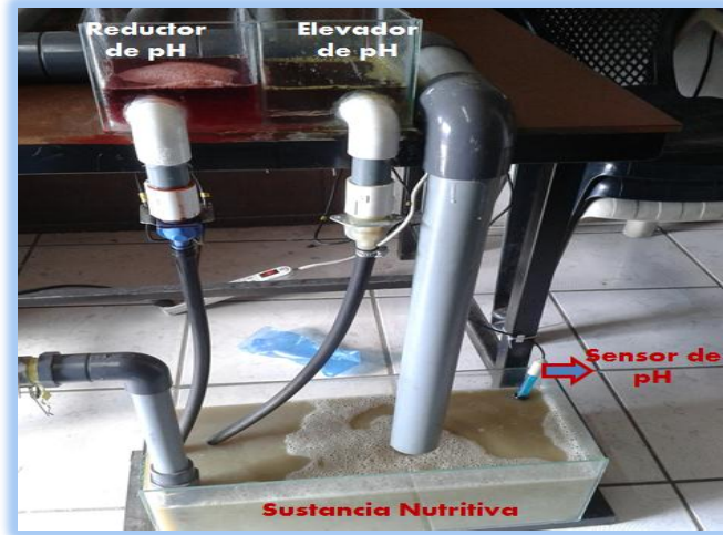
Figura N°.67 Electroválvulas dosificadoras
