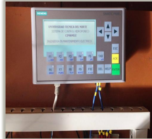
Figura 11 Inicio de proceso de pantalla HMI
