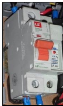
Figura 20: Breaker de 2 A
