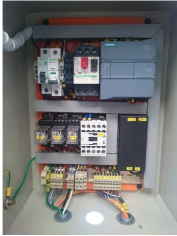
Ilustración 7: Tablero de control vista interna
