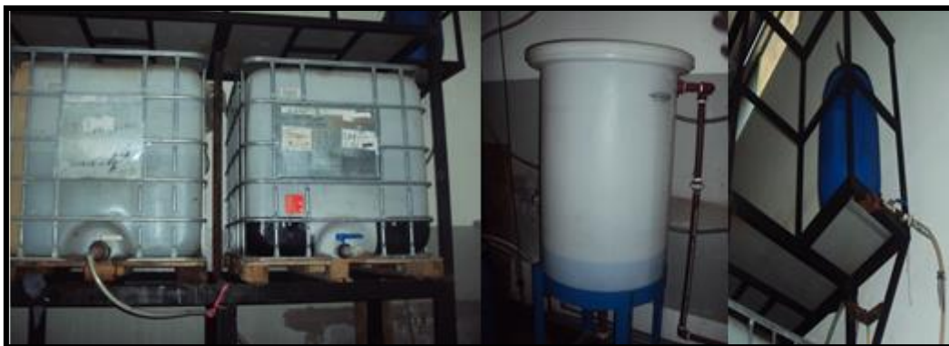
Figura N° 41: Tanques de productos 1, 2, 3 y 4
