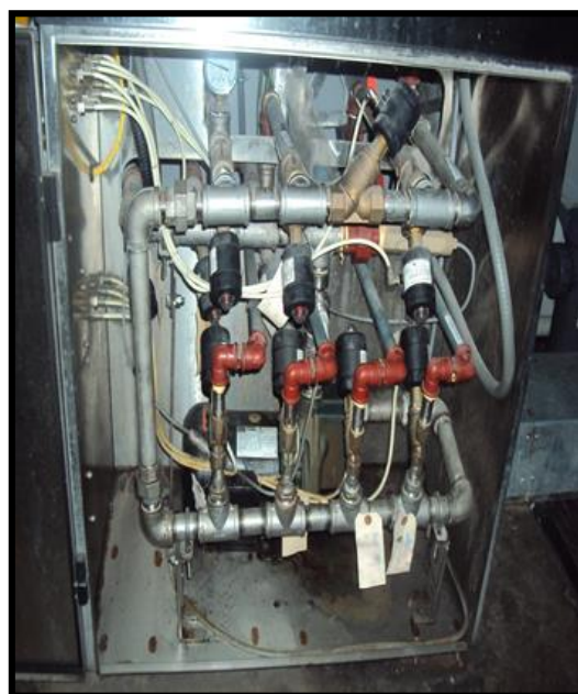
Figura N° 42: Válvulas del dosificador
