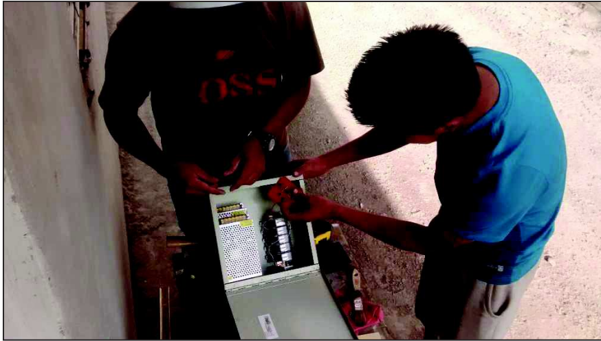
Figura 106: Ubicación de los elementos en la caja de la pluma grúa
