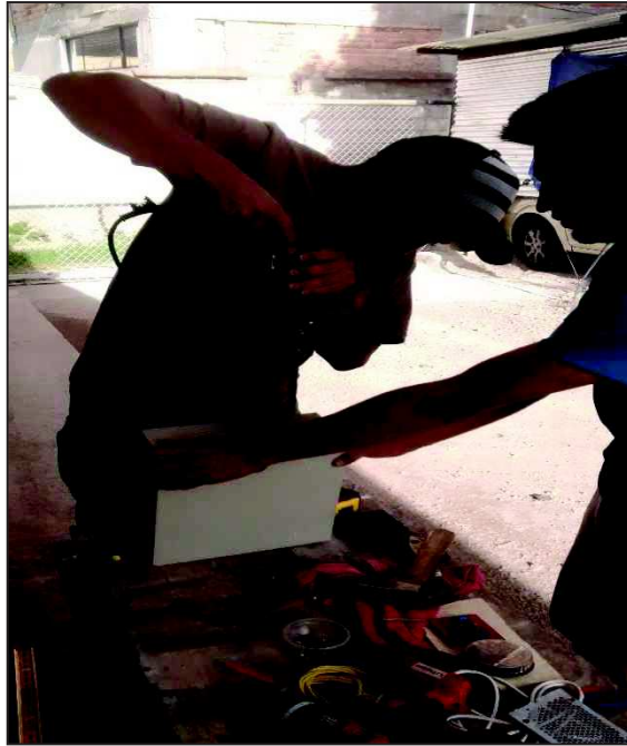
Figura 104: Perforación en la caja de conexión de la pluma grúa
