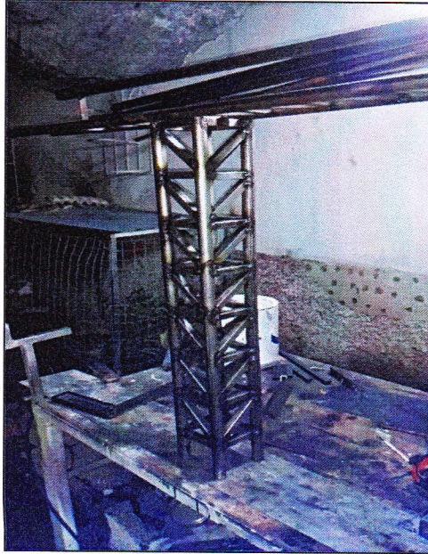
Figura 131: Torre de la pluma grúa.
