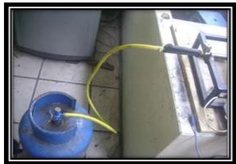
FIGURA 49: Tanque de gas al soplete 1
