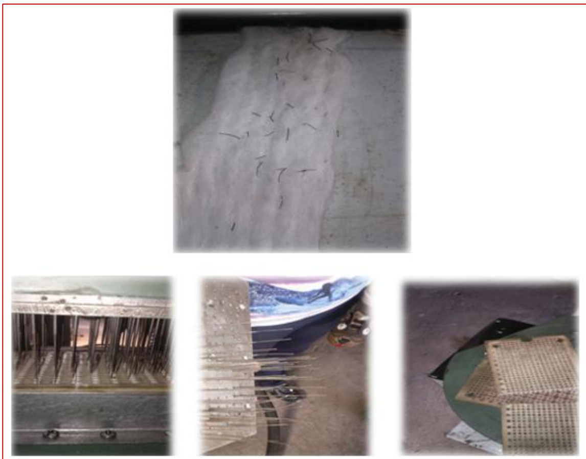
FIGURA 4.2: Rotura de Tablero de Nylon
