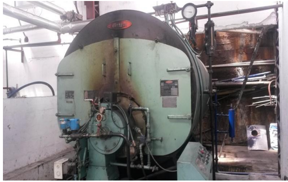
Ilustración 46: Caldero pirotubular de una lavandería
