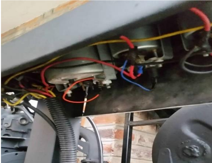
Figura 3.9. Arnés de Cables
