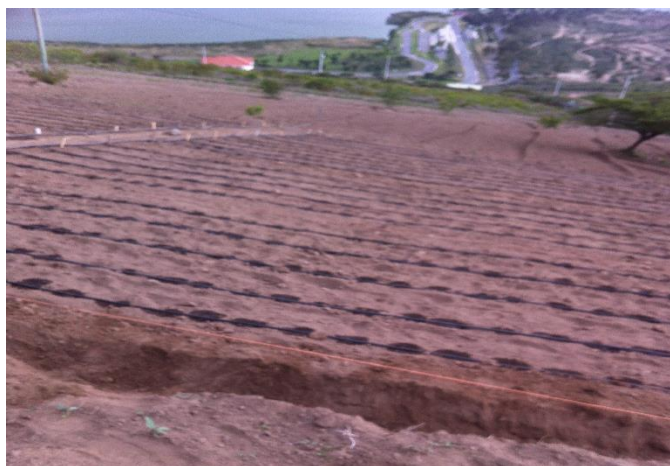
Figura 9. Sistema de riego por goteo y zanja de coronación en el sector de Aloburo
