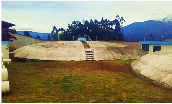
Figura 2. Tanque 1 de almacenamiento subterráneo de agua potable 1000 m3
