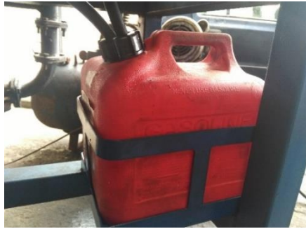
Figura 3.9. Depósito de combustible
