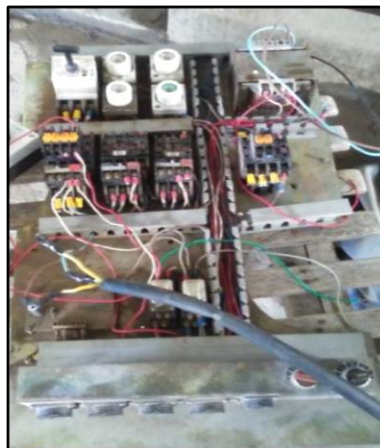
Figura 124. Tablero de control Fuente: Los autores
