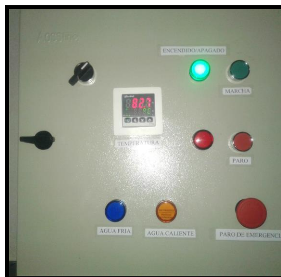
Figura 2.29.- Vista frontal tablero de control
