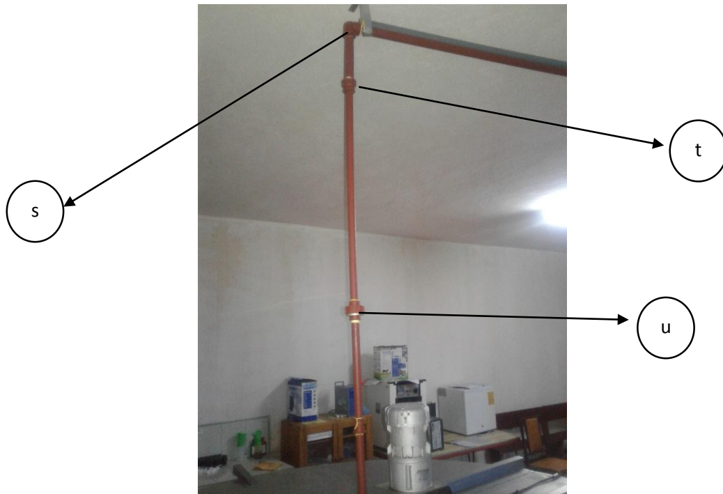
Figura 2.19.- Universal y codo a la entrada al tanque
