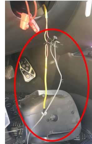
Fig. 24. Conexión del botón de pánico al canal dos del módulo relé.
