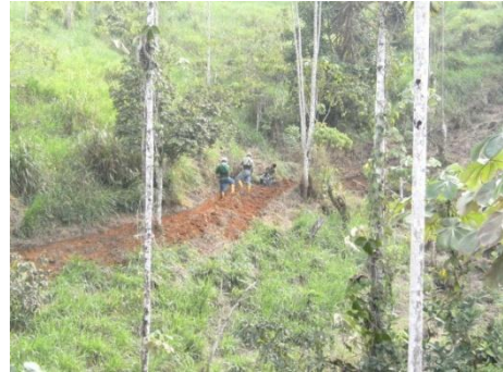
Foto 65: Cunetas de coronación
