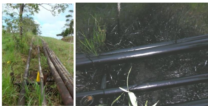
Fotografía 1: Punto del Derrame
