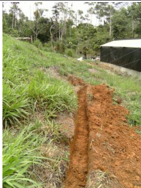
Foto 66: Cunetas de coronación
