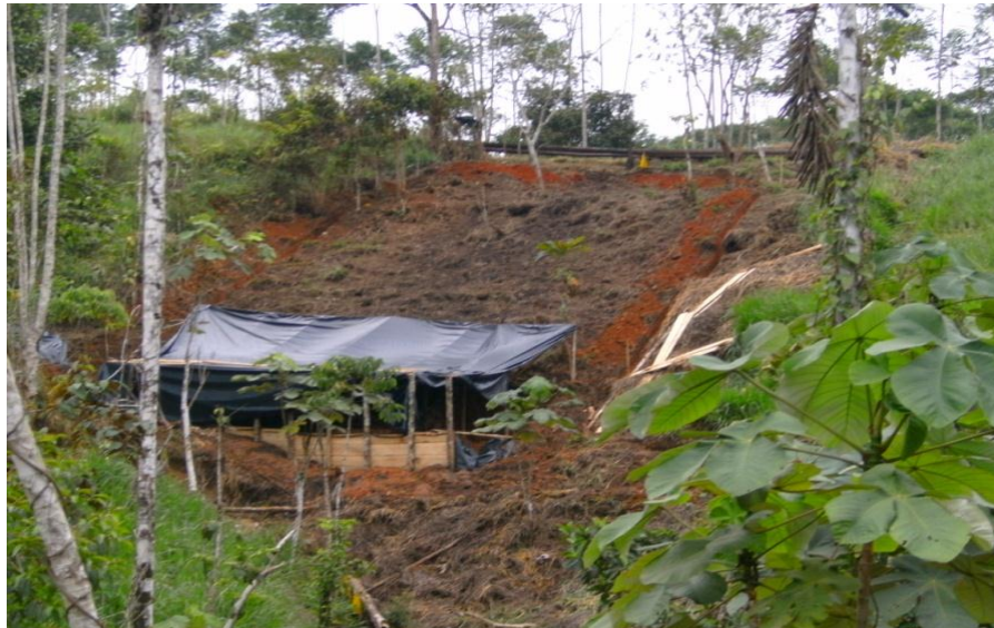
Foto 5: Delimitación física de área de suelo contaminado destinado al tratamiento
