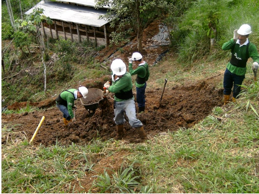
Foto 14: Extracción del lugar del derrame
