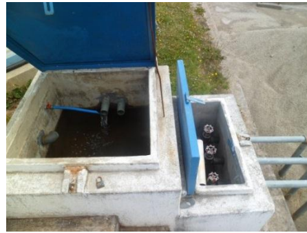
Fotografía 18. Cloración y repartidor de caudales
