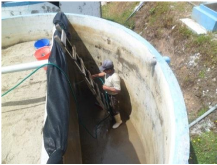
Fotografía 17. Desinfección de filtro dinámico ascendente
