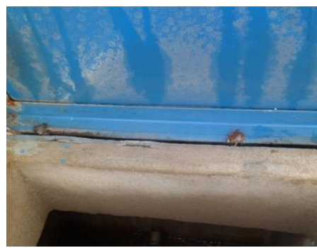
Fotografía 26. Estado de estructura de TRP
