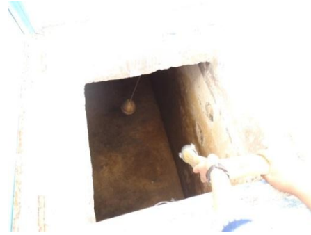
Fotografía 32. Llenado en tanques de reserva, época seca
