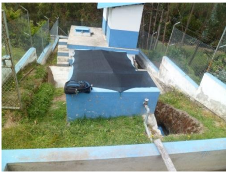
Fotografía 19. Planta de Tratamiento Jurapango Bajo
