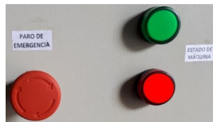
Figura 41: Señal luminosa de paro de emergencia
