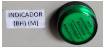
Figura 65: Indicador de bomba/motor conectados
