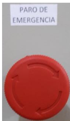
Figura 69: Paro de emergencia – Tablero
