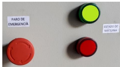
Figura 40: Señal luminosa de estado de máquina
