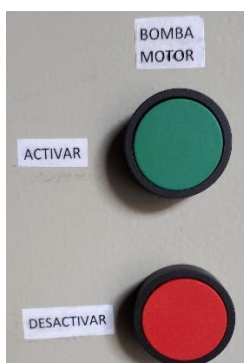
Figura 64: Pulsadores activar/desactivar Bomba/Motor – Tablero
