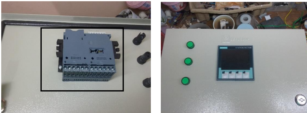
Figura 61. Medidor empotrado en la puerta del gabinete eléctrico BEAUCOUP Fuente: El autor
