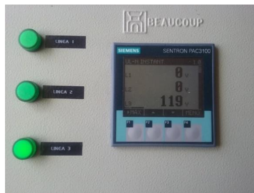
Figura 87. Funcionamiento: PAC 3100 con líneas en 0 Fuente: el autor
