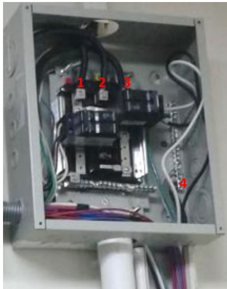
Figura 24. Tablero general de distribución eléctrica Fuente: El Autor
