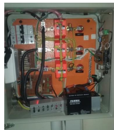
Figura 26. Nodo maestro del sistema en gabinete eléctrico
