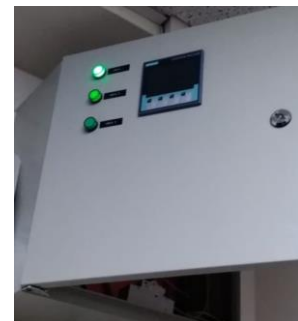
Figura 25. Nodo esclavo (PAC 3100) en gabinete eléctrico
