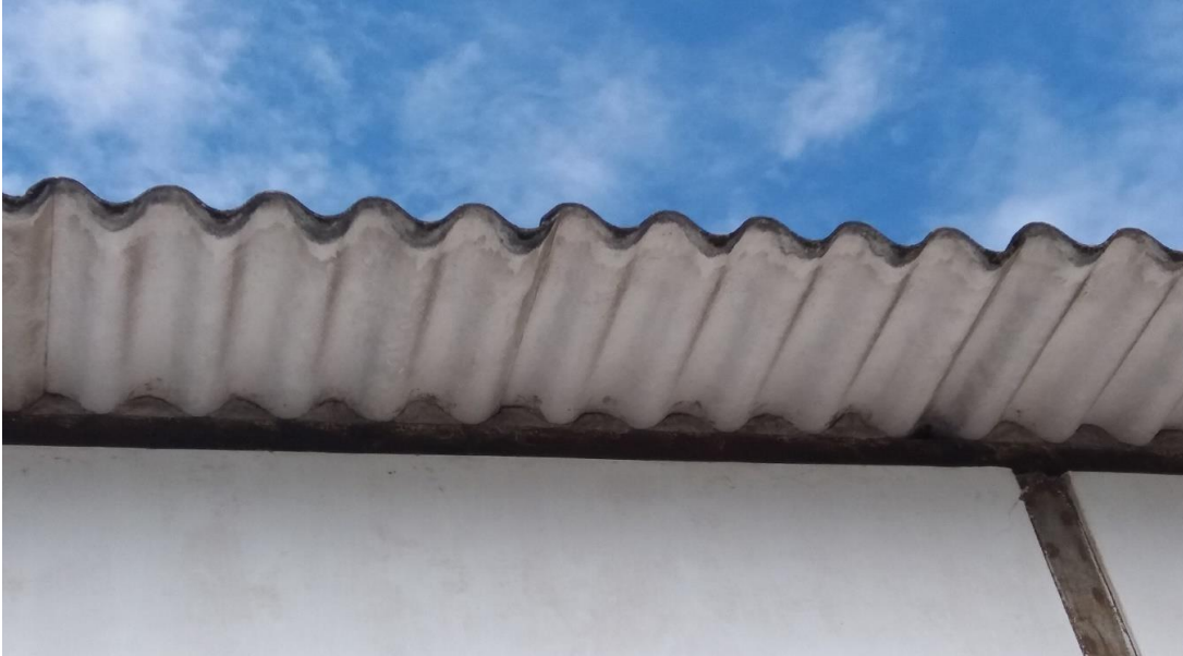
Figura III.1. Cubierta del taller sin instalación de canaletas de agua
