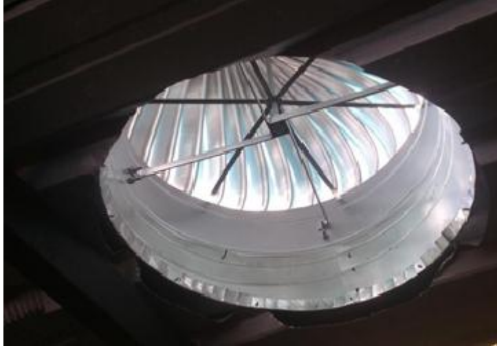
Figura IV.1. Vista interior del taller con instalación de ventilación eólica
