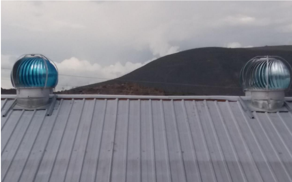
Figura IV.3. Cubierta del taller implementado Extractores Eólicos
