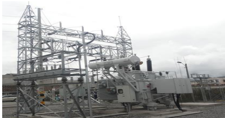
Fuente: subestación ajaví de la empresa eléctrica EmelNorte Elaborado por: Elizabeth Narváez
