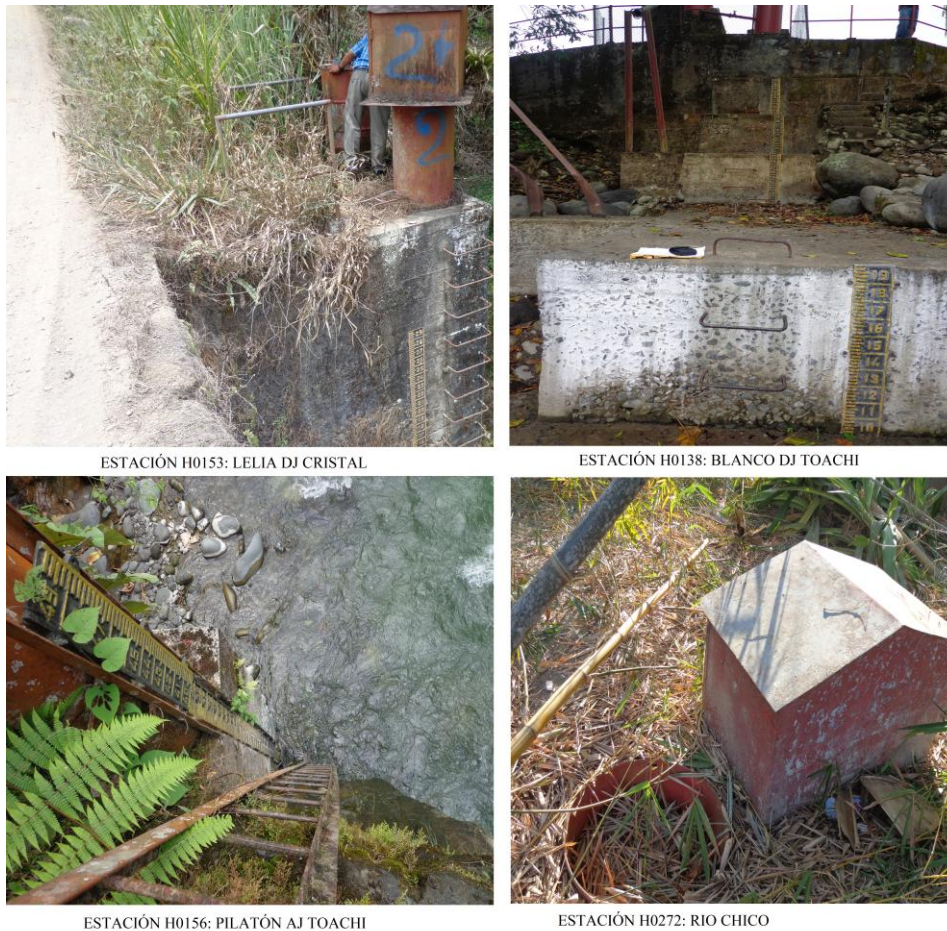
Figura 24. Infraestructura de las estaciones hidrométricas de la cuenca del Río Esmeraldas
