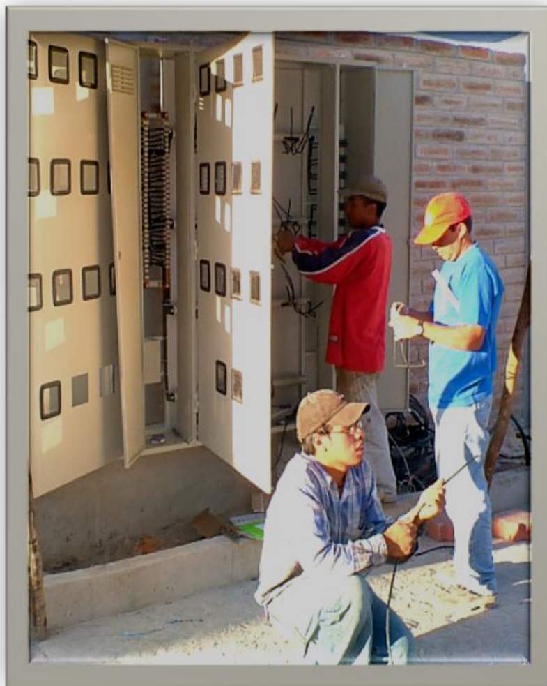
Cableado de un tablero bifásico de 30 medidores.
