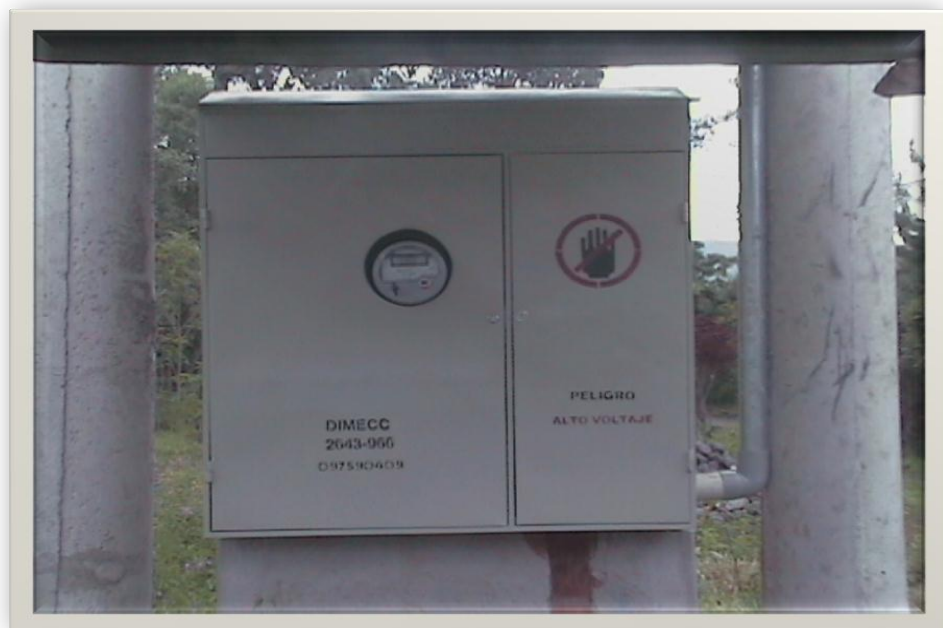
Instalación de un tablero especial en una industria
