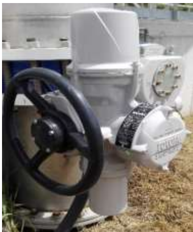
Fig. 35. Válvula reguladora de aire a biológico, existen 2 en esta sección (Autor).
