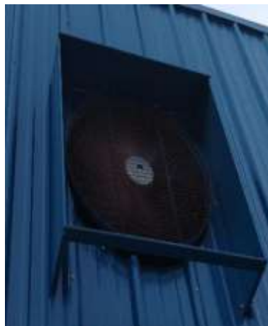
Fig. 41. Ventilador extractor, existen 2 en esta sección (Autor).
