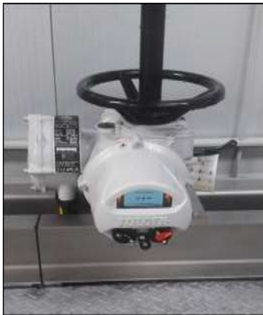
Fig. 25. Compuerta Mural desarenado, existen 3 en esta sección (Autor).
