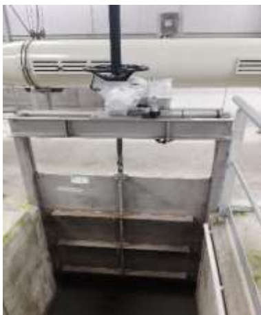
Fig. 21. Compuerta mural de canales de desbaste, existen 10 en esta sección (Autor).
