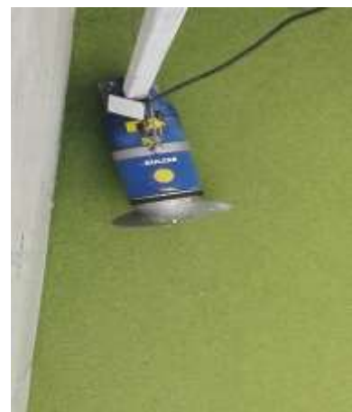
Fig. 37. Agitador sumergible, existen 2 en esta sección (Autor).
