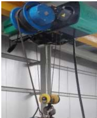
Fig. 19. Polipasto del pozo de llegada (Autor).
