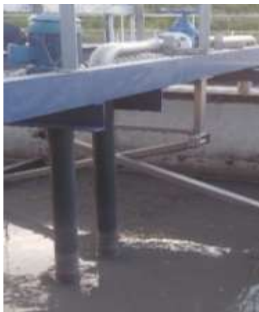
Fig. 26. Bomba de arenas, existen 2 en esta sección (Autor).
