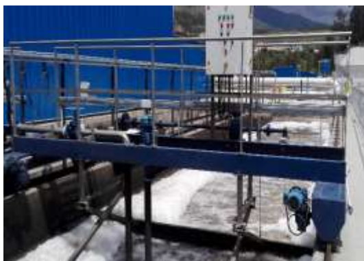
Fig. 28. Puente desarenador, existen 2 en esta sección (Autor).
