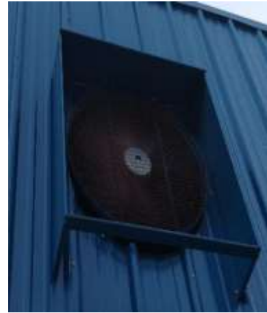
Fig. 32. Ventilador extractor (Autor).
