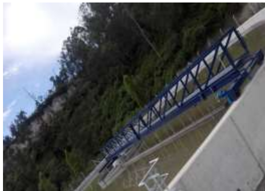
Fig. 33. Puente decantador, existen 2 en esta sección (Autor).
