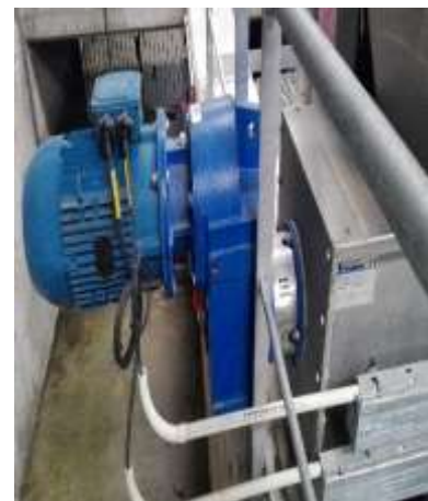
Fig. 23. Tornillo prensa transportador, existen 2 en esta sección (Autor).
