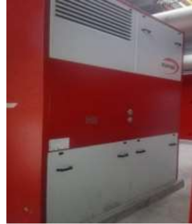
Fig. 40. Soplante con cabina insonorizante, existen 5 en esta sección (Autor).
