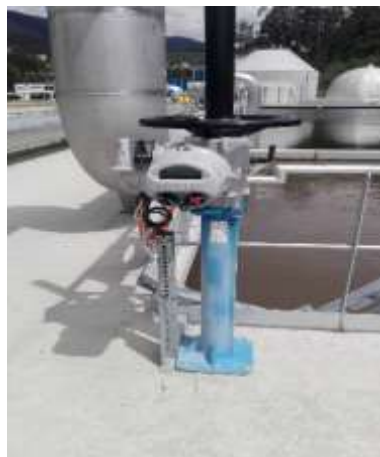
Fig. 36. Compuerta mural a biológico, existen 2 en esta sección (Autor).
