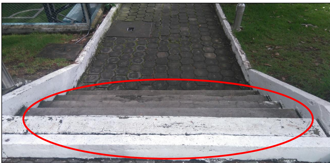
Figura 48. Escaleras extremo cancha sintética sin una rampa.
