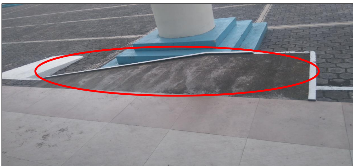
Figura 35. Rampa sin pasamanos que pone en riesgo la seguridad de personas con discapacidad visual
