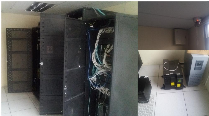
Imagen 12: Data Center UPEC Fuente: Elaboración Propia
