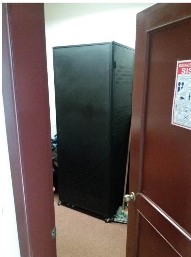
Imagen 13: Fácil acceso a los racks Fuente: Elaboración Propia
