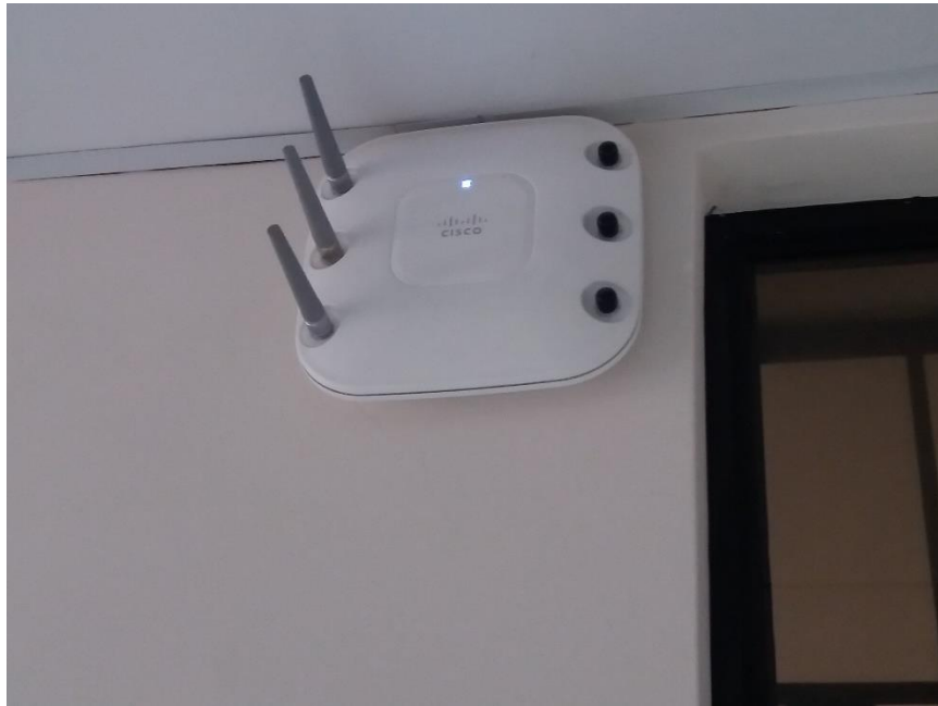
Imagen 1: AP CISCO ubicado en la pared en el edificio principal. Fuente: Elaboración Propia
