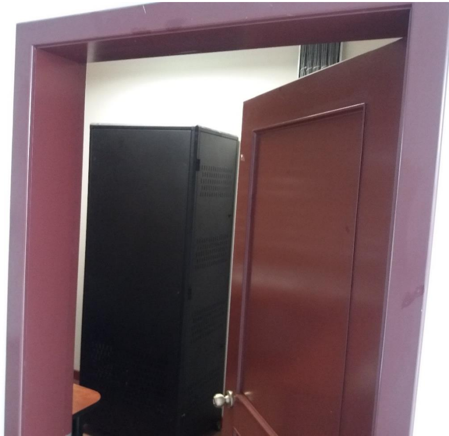
Imagen 39: Acceso a los Racks Fuente: Elaboración Propia
