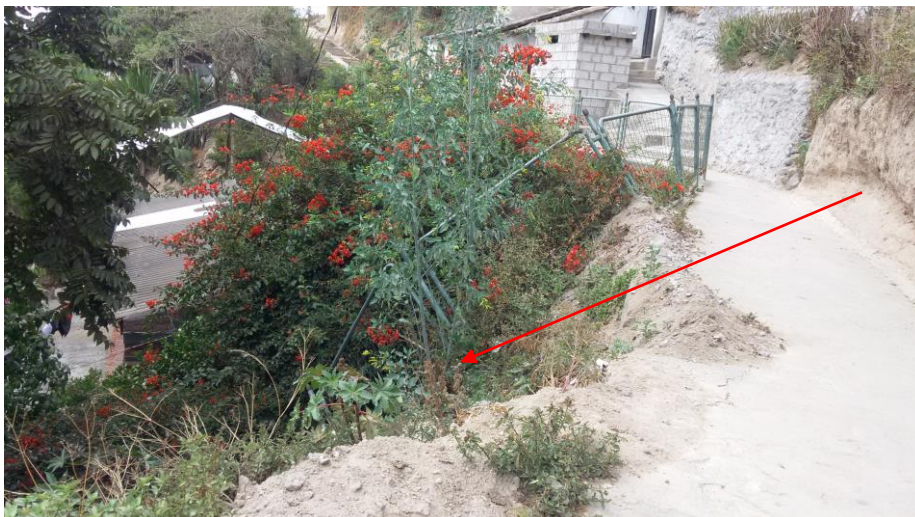
Foto 2.2. Vivienda y camino peatonal afectada por deslizamiento (Olivo Alto)
