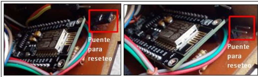
Ilustración 27. Desconexión del puente de reinicio
