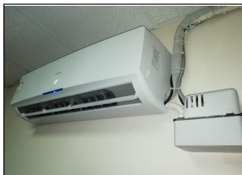
Figura 9 Sistema de aire acondicionado
