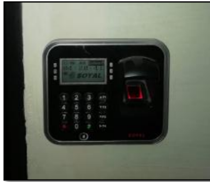
Figura 8 Sistema de control de acceso
