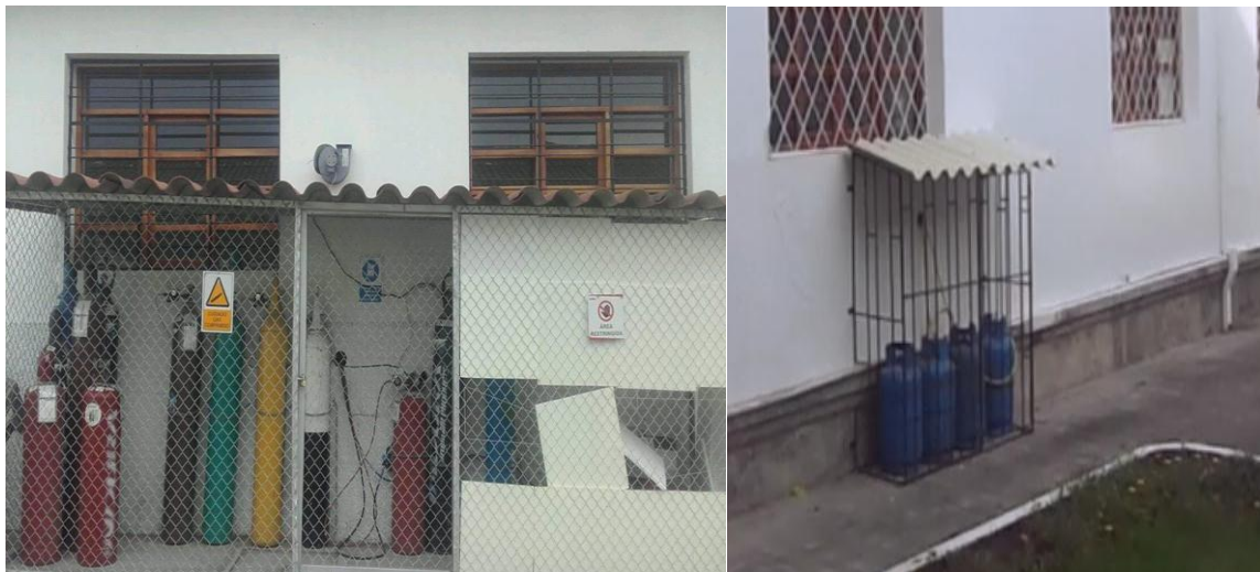
Figura 7: Tanques Industriales de gases comprimidos y GPL
