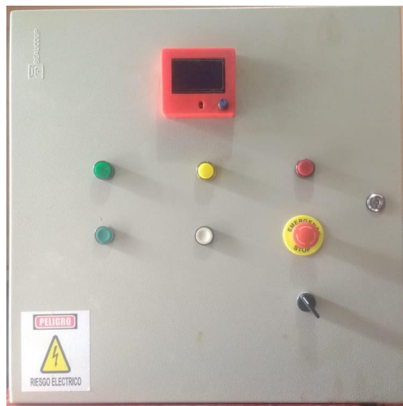
Figura 2.35. Gabinete de Control.
