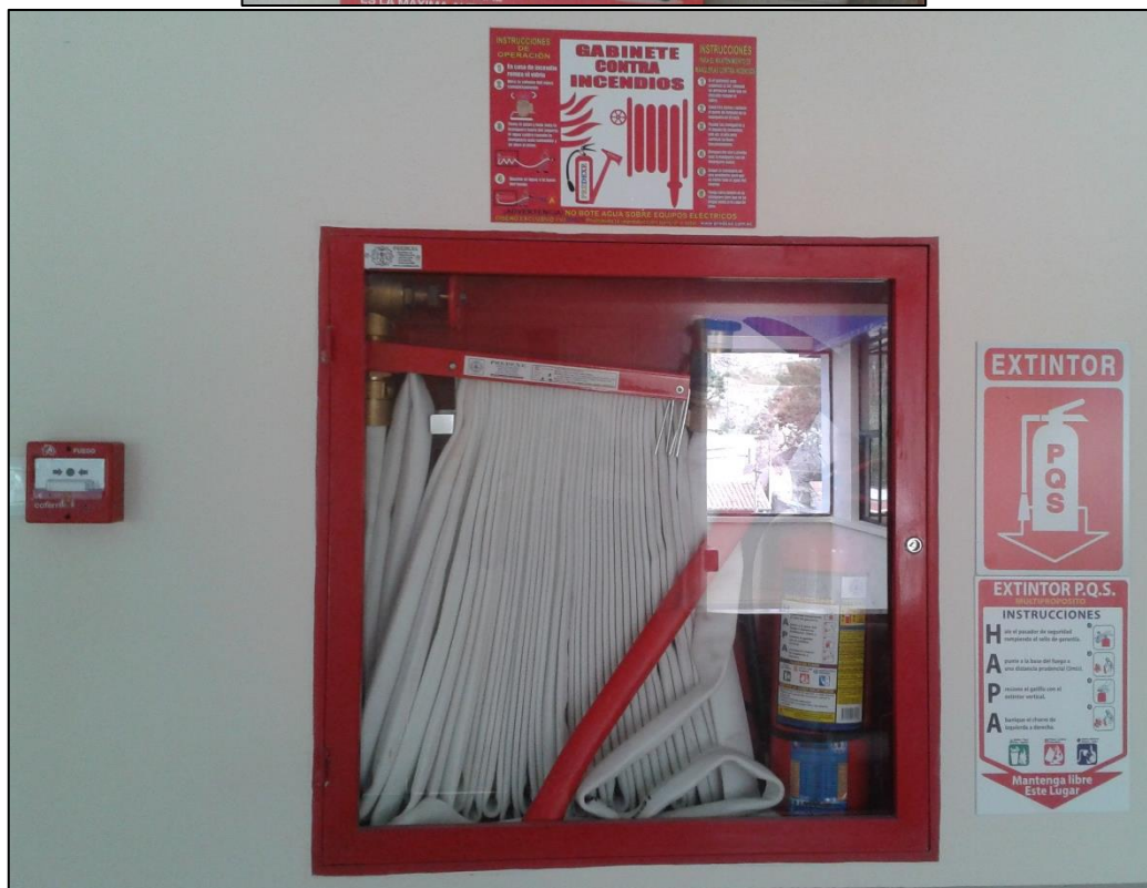
IMPLEMENTACION DE CARTELES INFORMATIVOS, SEÑALETICA Y EQUIPO CONTRA INCENDIOS
