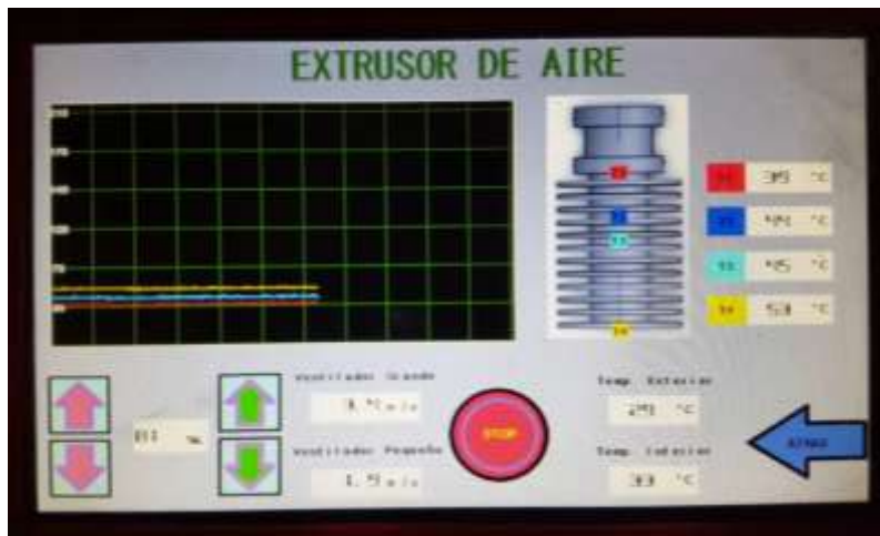
Figura 84: Interfaz de Visualización y Control de Parámetros en Pantalla HMI Extrusor de Aire
