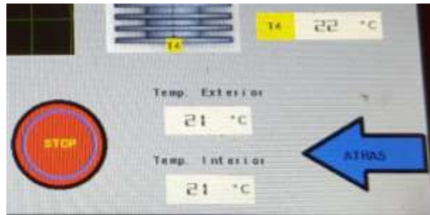
Figura 82: Parámetros de Temperaturas Externa e Interna de la Plataforma en Pantalla HMI
