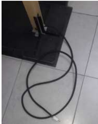
Figura 4.5 Cable de poder cubierto con la manguera corrugada
