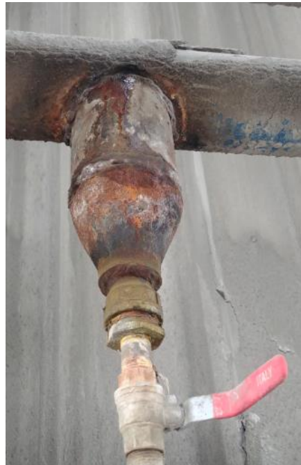
Figura 3.10. Fuga visible en la tubería.
