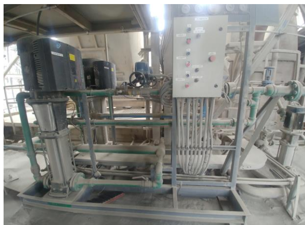
Figura 3.6. Spray de agua Precaentador 1.
