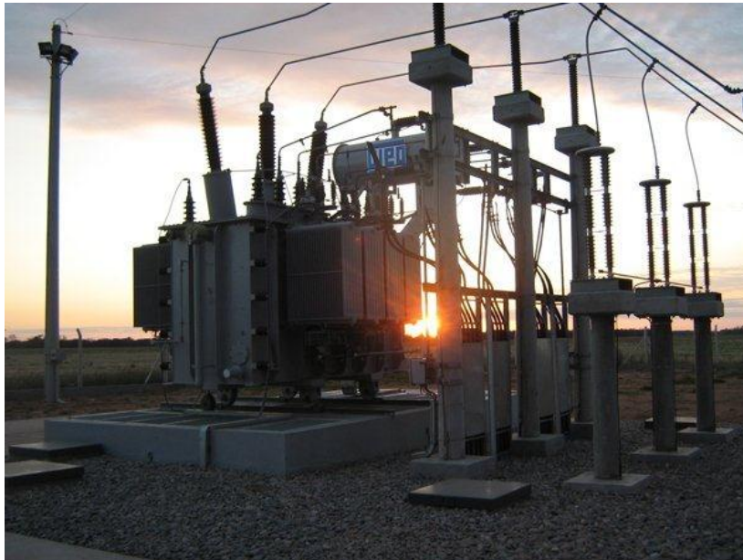
Fig. 12. Transformador de potencia
