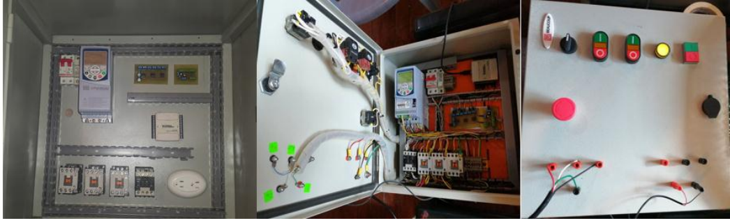
Figuras 47. Montaje, cableado y conexiones externas del módulo de pruebas
