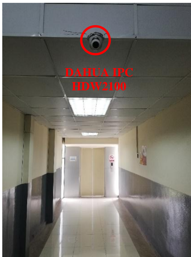
Figura 76. Orientación de la cámara en el primer piso de la FICA apuntando simultáneamente al pasillo y a las escaleras de subida y bajada.
