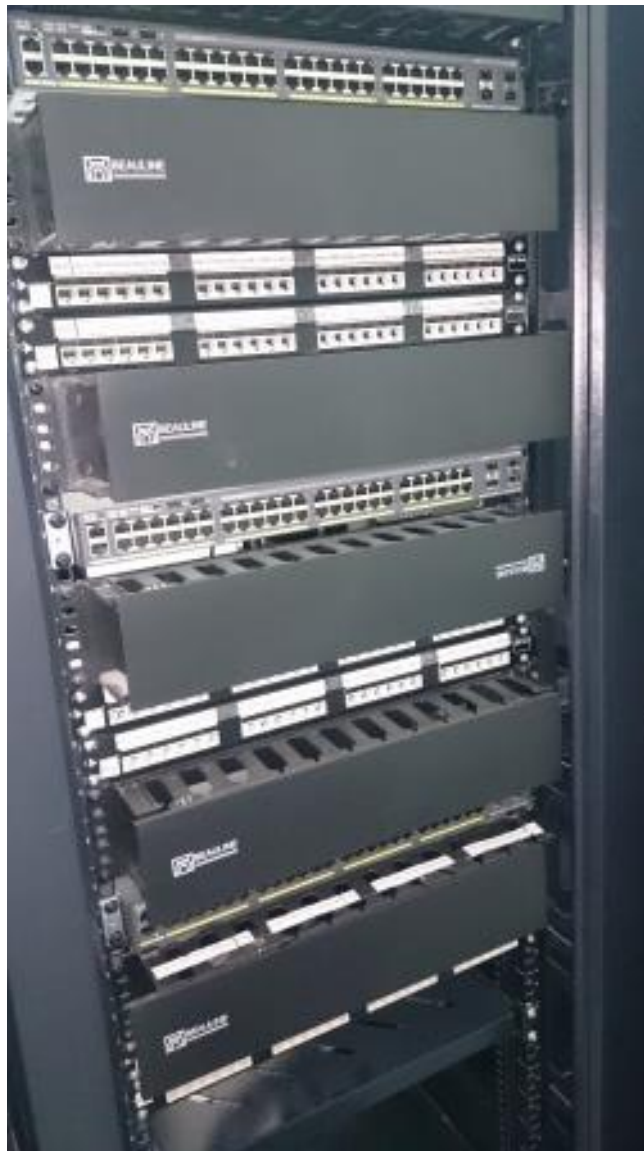
Figura D- 7. Etiquetado de patcHPanel en racks Fuente: Propia Autor, (2019).
