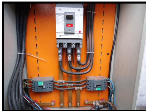
Figura D- 13. Ubicación de tablero de distribución principal (TDP) Fuente: Centro de datos RECAPT, (2016).
