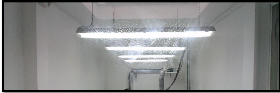
Figura D- 21. Iluminación en el centro de datos Fuente: Centro de datos RECAPT, (2016).
