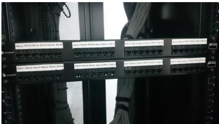
Figura D- 6. Etiquetado de los puntos de red en patchPanel Fuente: Propia Autor, (2019).
