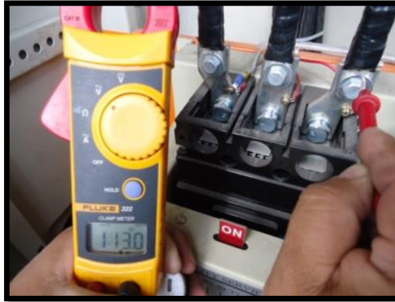
Figura D- 19. Medición de voltajes entre fases 2y3 en STD Fuente: Propia Autor, (2019).
