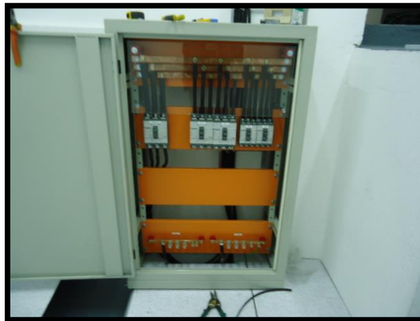
Figura D- 15. Tablero de distribución en centro de datos Fuente: Centro de datos RECAPT, (2016).
