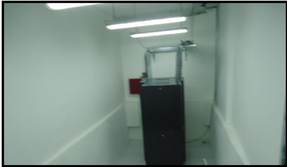
Figura D- 11. Vista Lateral del centro de datos ubicación de racks Fuente: Centro de datos RECAPT, (2016).
