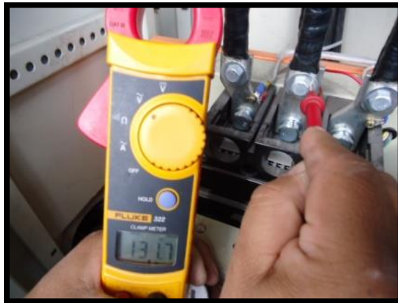
Figura D- 18. Medición de voltajes entre fases 1y3 en STD Fuente: Propia Autor, (2019).
