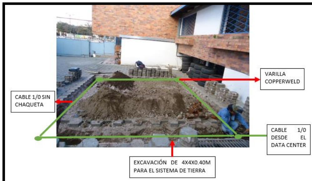
Figura D- 25. Sistema de puesta en tierra de alta frecuencia Fuente: Centro de datos RECAPT, (2016).
