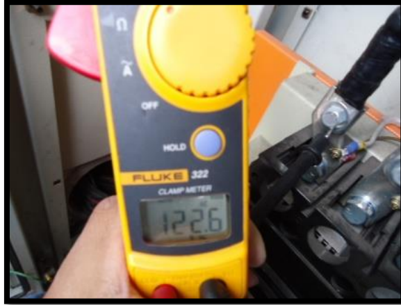
Figura D- 17. Medición de voltajes entre fases 1y2 en STD Fuente: Propia Autor, (2019).
