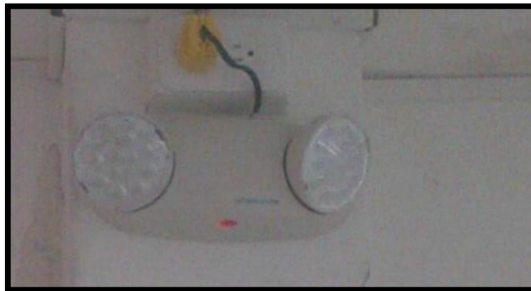
Figura D- 22. Iluminación de emergencia en el centro de datos Fuente: Propia Autor, (2019).
