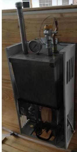
Figura 33: Fusión del calefón con el tanque Fuente: Autor
