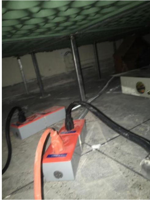
Figura 59. Acometidas Data Center FICA. Fuente: El Autor
