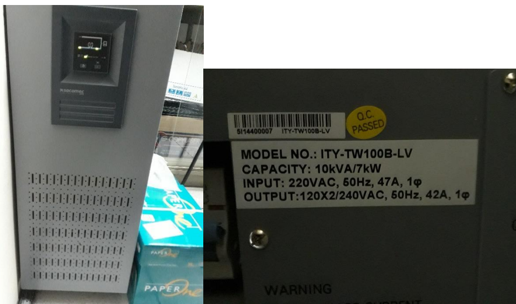
Figura 64. UPS Vista Frontal y de Placa Data Center FICA. Fuente: El Autor.
