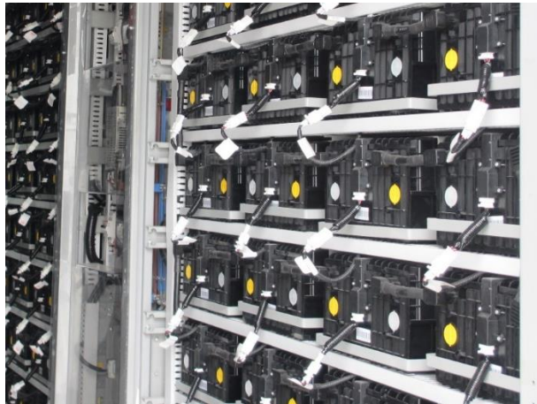
Figura 16. Disposición de Baterías en Data Centers. Fuente: In Contract, (2017).
