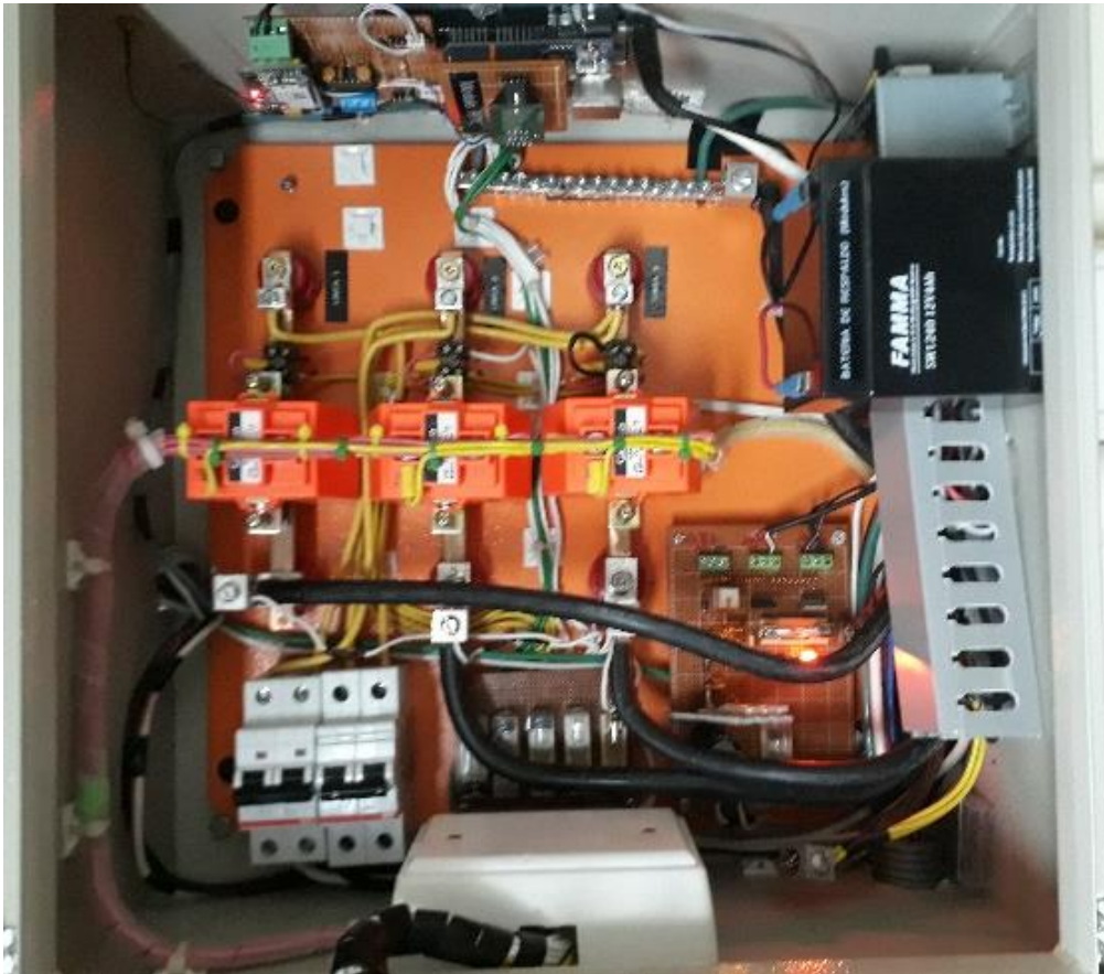
Figura 60. Tablero Eléctrico. Fuente: El Autor.
