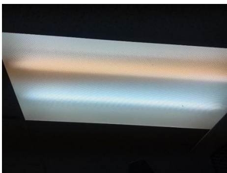
Figura 65. Luminarias Actuales Data Center FICA. Fuente: El Autor.
