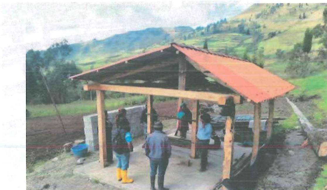
Figura 14. Construcción de casetas de ordeño para buenas prácticas de producción lechera, agosto 2018.
