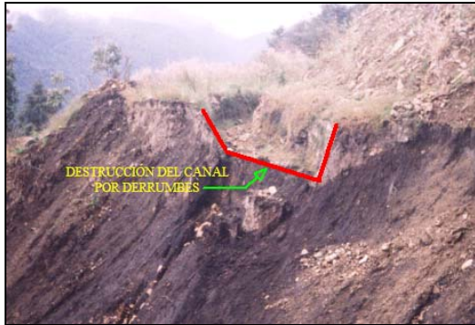
Foto N° 20 Fraccionamiento del Canal Producido por Derrumbes
