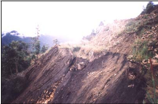
Foto N° 19 Derrumbo por Inestabilidad de Taludes
