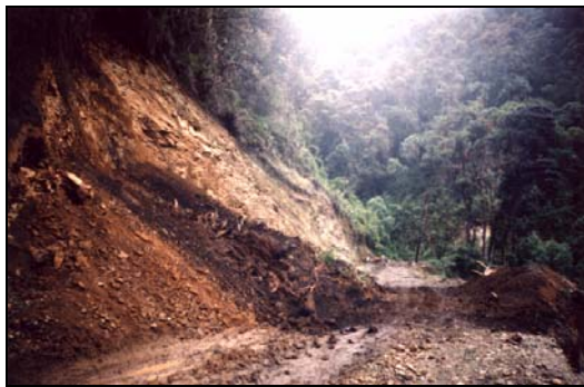
Foto N° 15 Derrumbes producidos por inestabilidad de taludes
