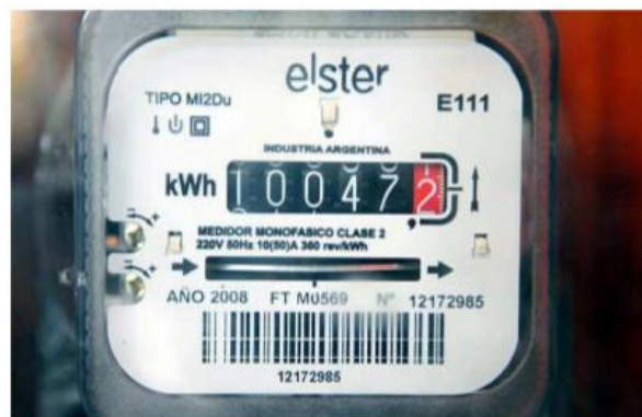
Fig. 2 Contador de energía electromecánico.
