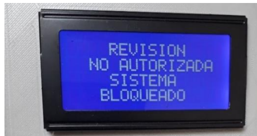
Fig. 69 Revisión no autorizada del medidor.
