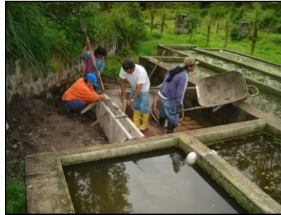
Foto 3.6. Tanque de lodos sistemas dos
