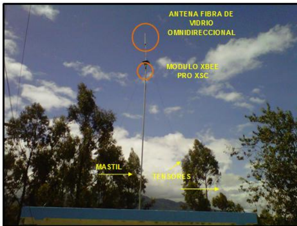
Fig. 19.- Infraestructura para la colocación de la antena en la Estación de Bombeo II
