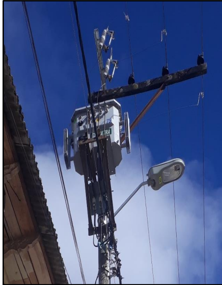
Fig. 12 Centro de transformación tipo pedestal. Fuente: (EMELNORTE, 2019).
